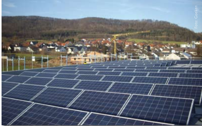
Das Dach des neuen Gebäudes bot beste Voraussetzungen zur Installation einer selbst genutzten Photovoltaikanlage.
